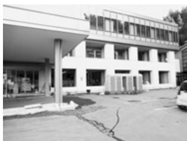
穴水町役場前（亀裂が入り、所々破損が見受けられます。）
